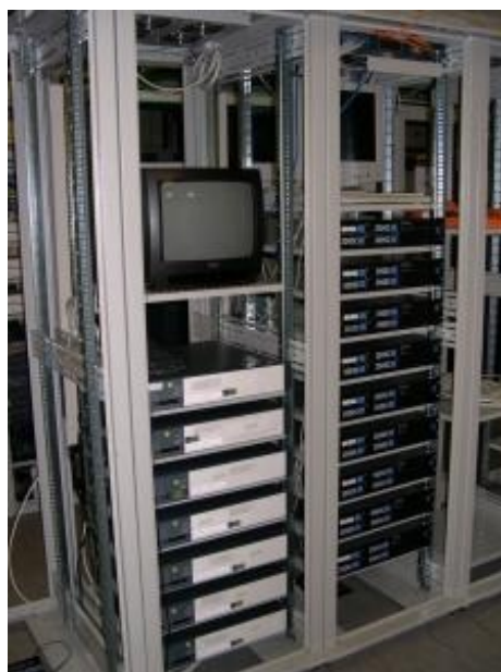
Une baie de serveurs
